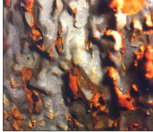
Şekil 7. 105°C kazan suyuyla ısıtılan çift katlı sıcak su boilerindeki cidarlarında çökme korozyonu da görülen kabaran galvaniz tabaka
