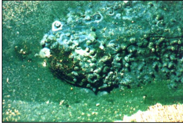
Şekil 13. Bakır soğuk su borusunda çökme korozyonu tip 1 üzerindeki kabarcık
