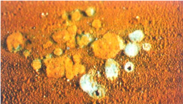
Şekil 15. Bakır sıcak su borusundaki tipik delik korozyonu tip 2
